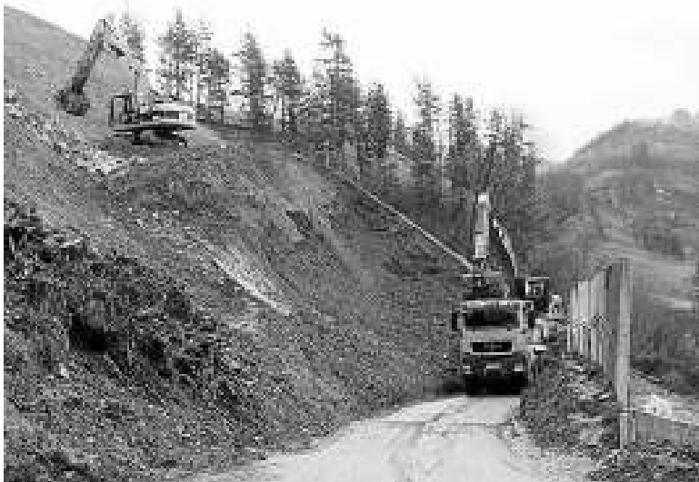
Máquinas trabajando en el desprendimiento. FOTO: JABI LEON
